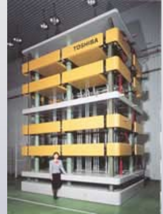
DC 125kV 300 MW Fig.5
