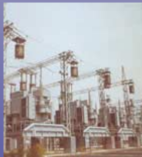
DC125kv 300MW Fig. 1
