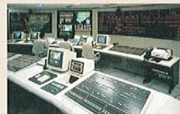
中央監視室 Central monitoring room
