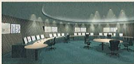
発電監視制御システム TOSMAP-DS Distributed control system TOSMAP-DS
