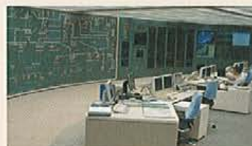
電力系統監視制御システム Computer control systems for electric power systems
