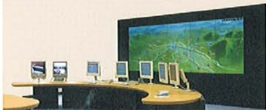
上下水道監視 制御システム TOSWACS TOSWACS water purification and sewage treatment control system
